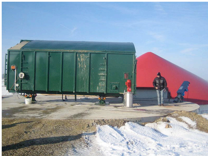
Abb. 5: Bioenergie Ohrenbach GmbH & Co.KG: Teilversenkter Fermenter mit Einbringtechnik und Rührwerk. Im Hintergrund Nachgärlager mit Gasspeicher.
