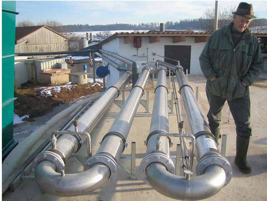
Abb. 6: Gasleitung zum BHKW. Zunächst wird das Gas gekühlt und das enthaltene Wasser auskondensiert. Das Kondenswasser läuft dem Gefälle folgend zurück in den Nachgärer. Eine anschließende Erwärmung temperiert das Gas vor dem Eintritt in das BHKW.
