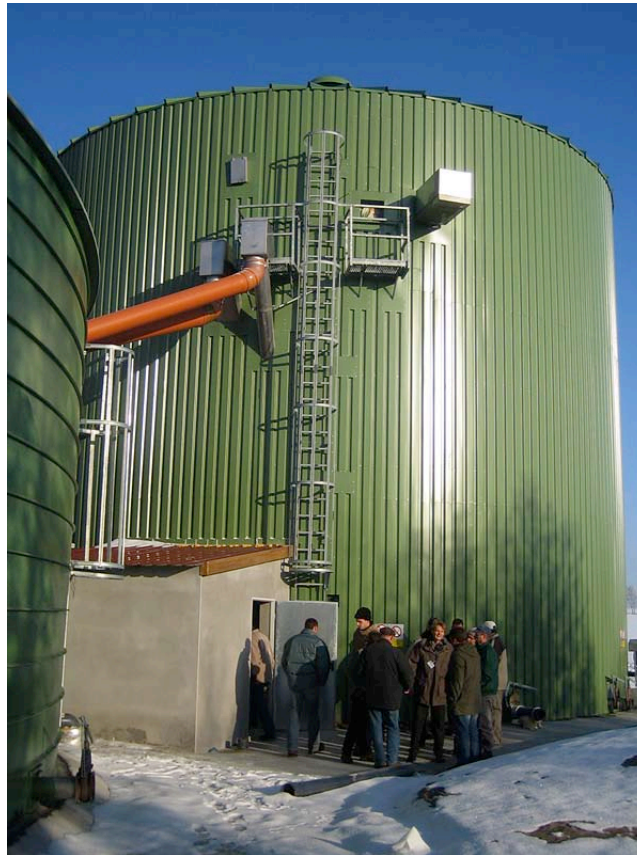
Abb. 4: Biogasanlage Gullmann/ Zink GbR: Gärbehälter mit Überlauf zum Nachgärbehälter und Technikgebäude
